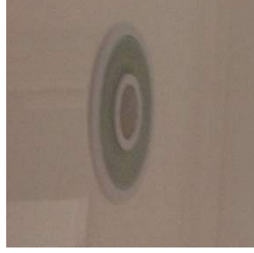
Light / Fan Unit
